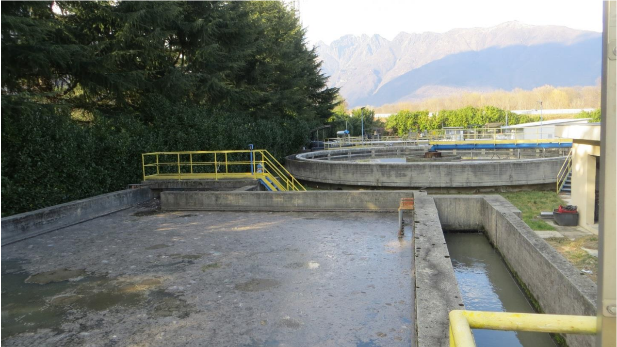
Impianto esistente: zona vasca equalizzazione esistente (non utilizzata) e sedimentatore primario
