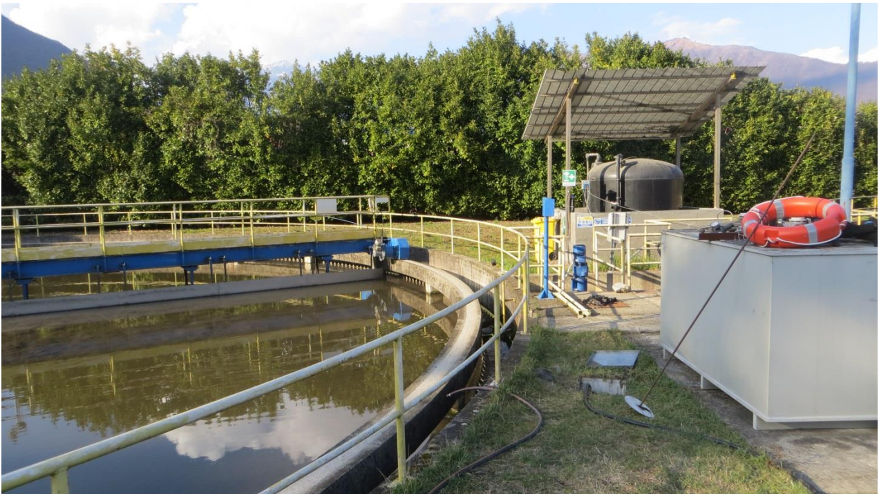
Impianto esistente: sedimentatore secondario esistente
