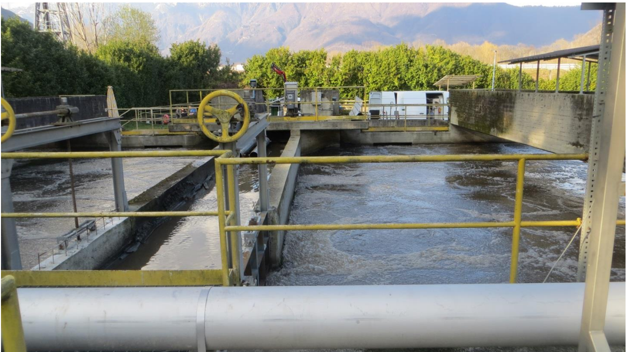
Impianto esistente: reattori biologici eserciti con aerazione intermittente
