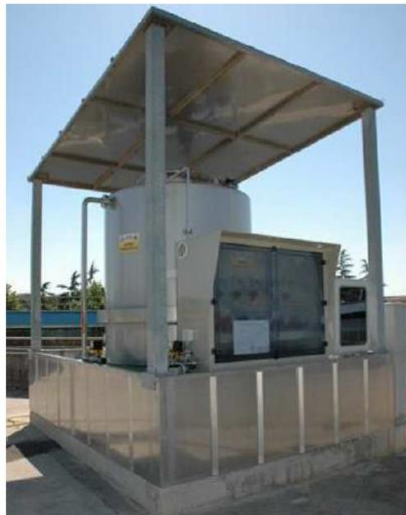
Esempio impianto dosaggio acido peracetico sotto tettoia di copertura
